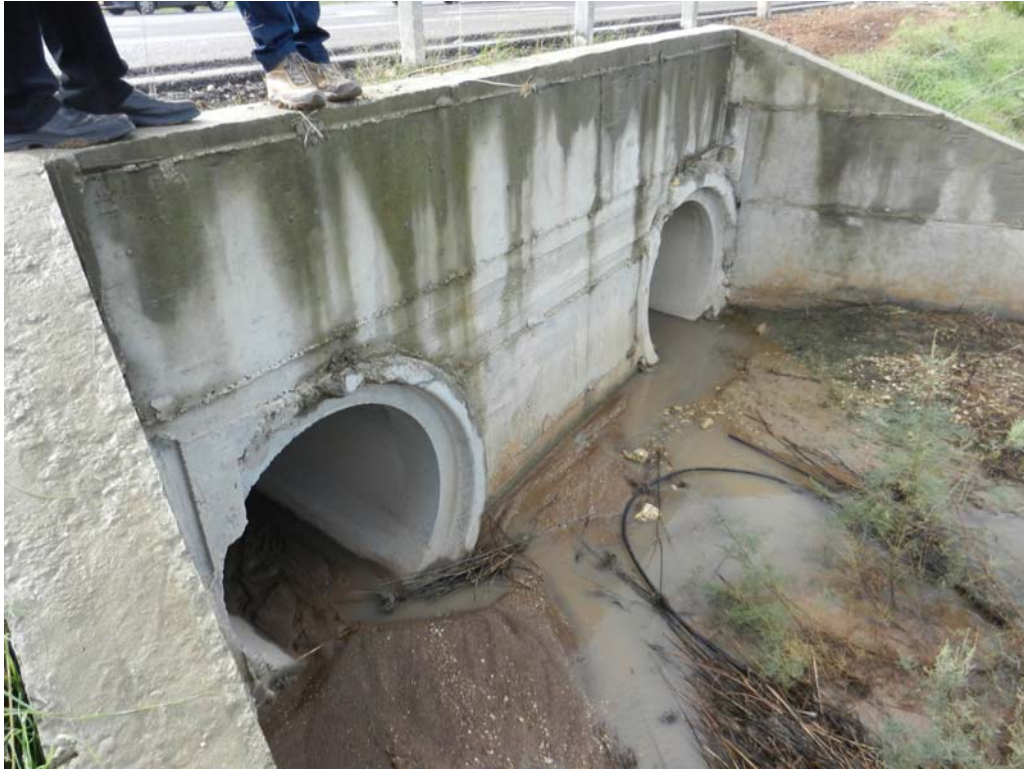
איור 40 : מעביר המים העובר מתחת לכביש 9 בקטע המבחן, הבנוי משני צינורות בקוטר של 120 ס"מ (צילום : א. גזית, 2012)
